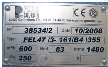
Plaque signalétique de la pompe du forage
