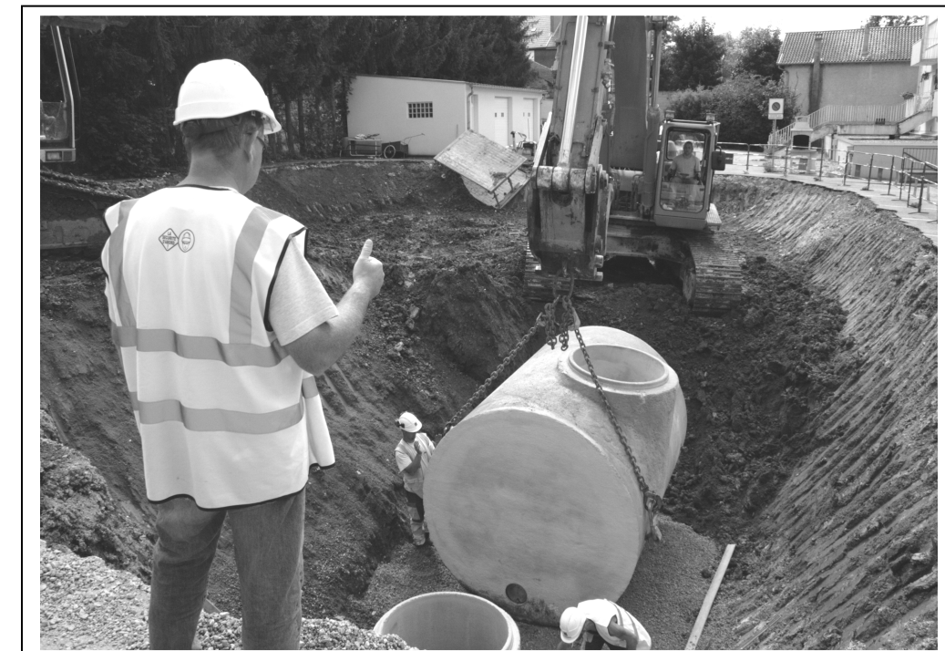
Photo d'illustration sur une sortie de bassin de rétention.
