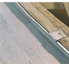
1. Mise en place de la noue métal façonnée, à relevés contre liteau filant et patte de fixation.
