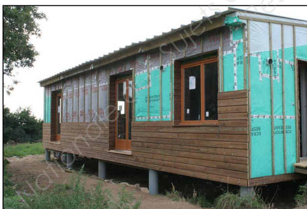
Figure 3 Bardage en bois à l'aide de lattes de 12 mm d'épaisseur placées transversalement contre l'isolant qui a au préalable été imperméabilisé.
