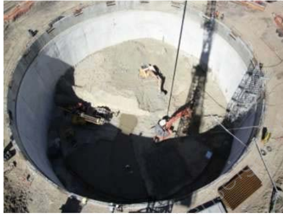
Figure 2 : un bassin d'orage source FranceBTP.com
