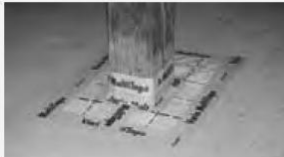
Jonctions entre les planchers, les passages de conduits, les trappes et l'isolation.
