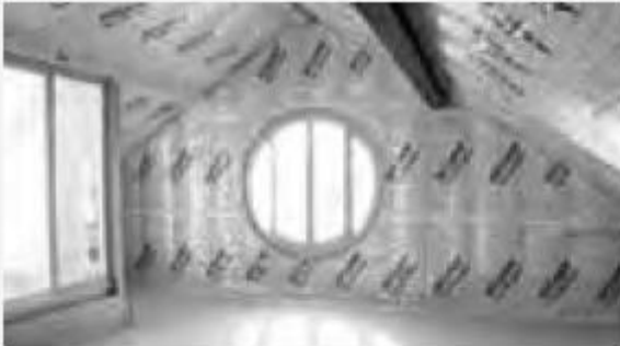
Isolation ayant une résistance thermique élevée, posée en continu.
