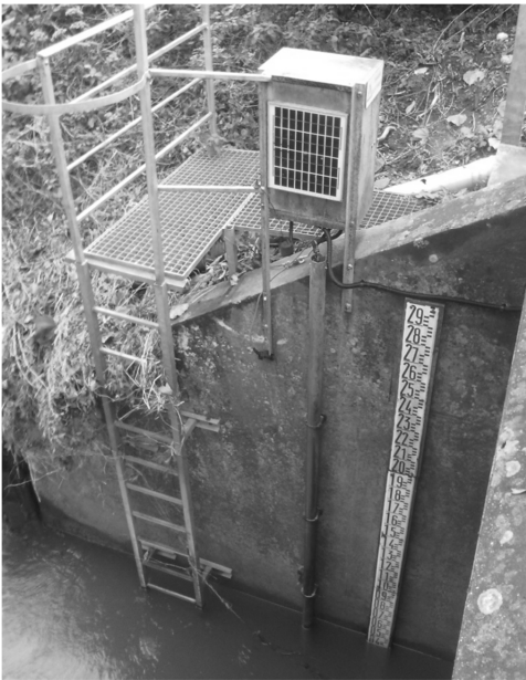
Fig. 2 : la station de collecte de Wirwignes
