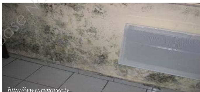
Traces sur le mur de la buanderie
