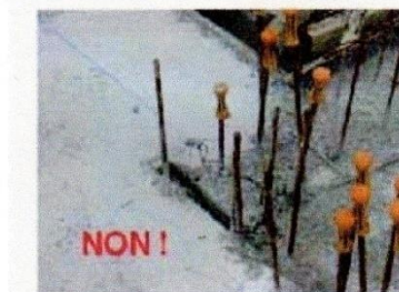
Fig. 14 Bouchons d'attente de diamètre insuffisant
